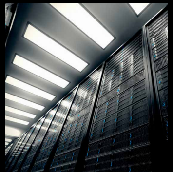
Rechenzentren und Infrastruktur
