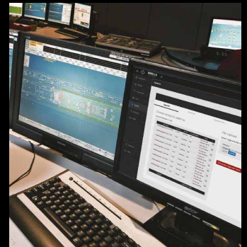
AV and Room Control
