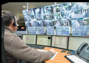
Salles de commande et de contrôle
