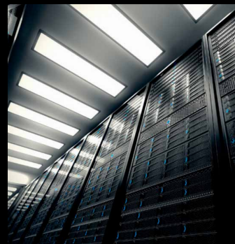
Centre de données et Infrastructure
