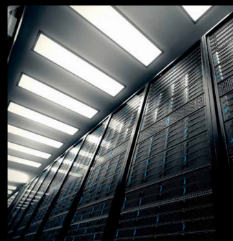
Centro dati e infrastruttura
