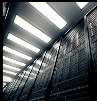
Redundante und Remote-Netzwerke
