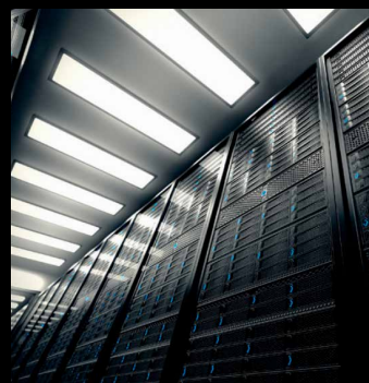
Centro dati e infrastruttura
